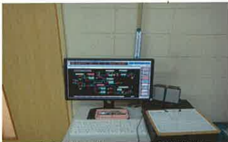
中央監視制御システム(計装設備) 24時間体制で配水池への送水状況を集中監視しています。
