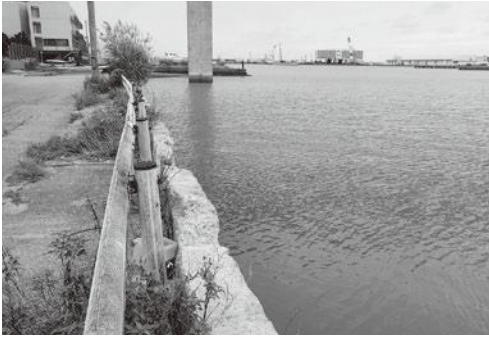
決壊が見られる旧ボウリング場北側護岸
