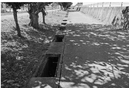
潮崎緑地の蓋がない側溝
