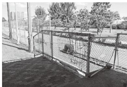
西川町公民館の壊れたフェンス
