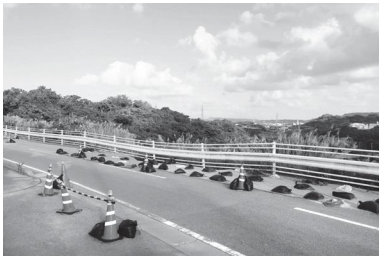
早急な対応が望まれる狭間線の崩落箇所
