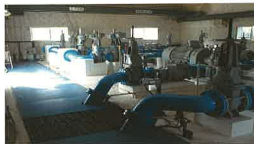
5基のポンプで毎日およそ 18,000\text{m}^3 の水を送水しています。
