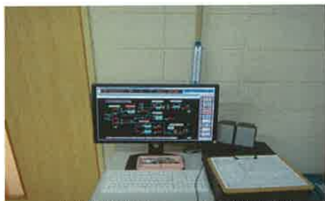
中央監視制御システム(計装設備) 24時間体制で配水池への送水状況を集中監視しています。
