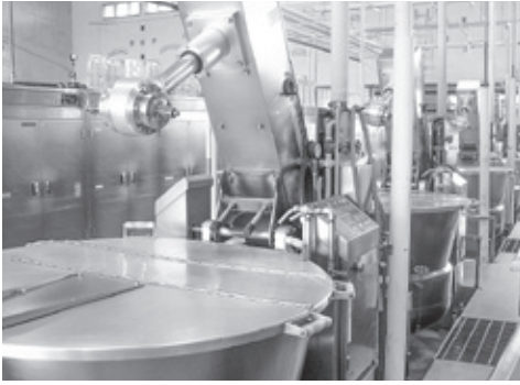
糸満市立学校給食センター調理室内
