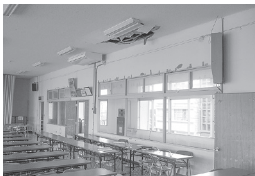
糸満漁業協同組合漁民研修施設の崩落箇所
