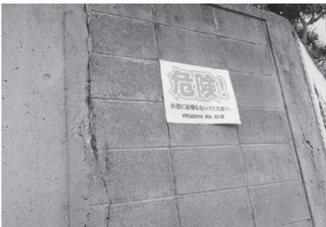
ひび割れのブロック塀に注意を促す表示（高嶺中学校）
