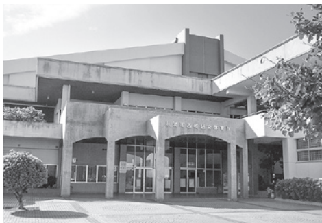
早急な雨漏り対策が求められる(西崎総合体育館)
