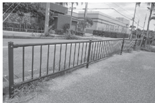
通学路の安全を守るガードパイプ
