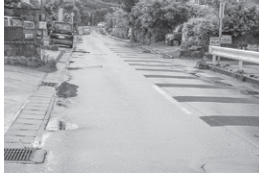
集中豪雨時に冠水する兼城浜川地区
