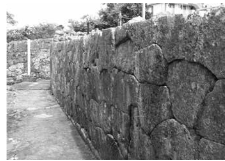
修復が必要な石積み(大城家)
