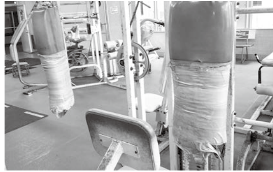
老朽化の著しいトレーニングルーム
