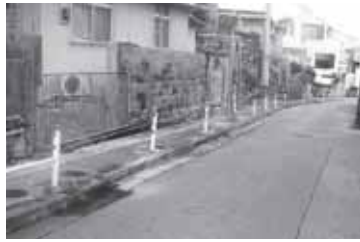
早急な修繕が望まれる
