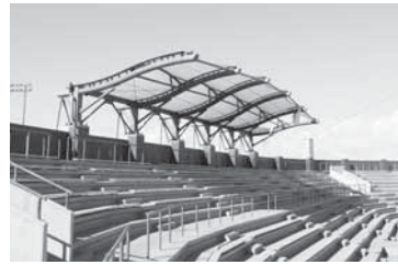
破損している西崎球場の日よけドーム
