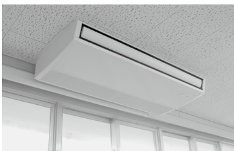
高嶺小学校理科室のクーラー (平成26年度設置)
