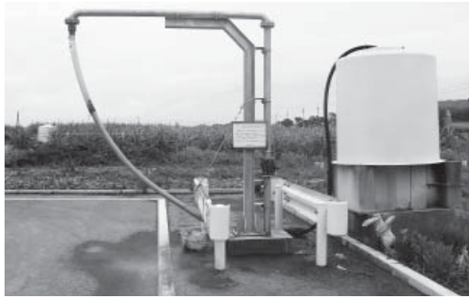
与座地域に設置されたⅢ型かんがい施設
