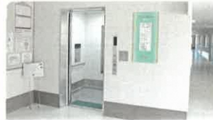
エレベーター
