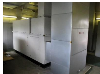
<自家発電施設>
