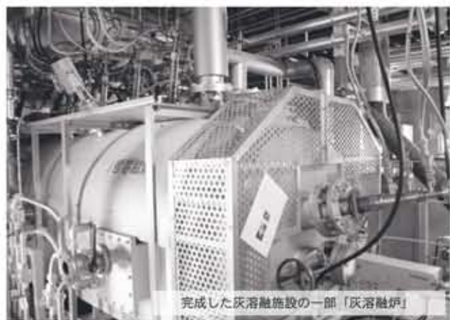
完成した灰溶融施設の一部「灰溶融炉」 生成された溶融スラグはアスファルトの材料などにリサイクルされます
